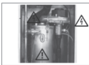
Запалим трафопост, запалителен електрод с високо напрежение, горяща камера
