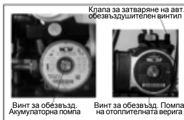
Обезвъздушаване на помпата на отоплителната верига и на акумулаторната помпа
