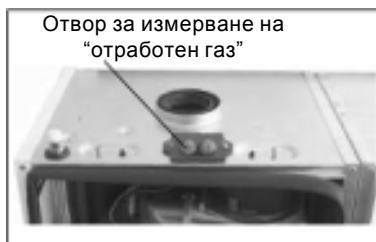
Измерване на отработения газ при отворен уред
